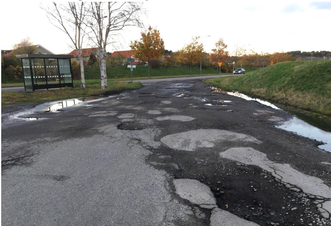
Figur 9. Infart till Lysevägen från Flyghamnsvägen. Väg i dåligt skick och bristfällig dagvattenhantering.
